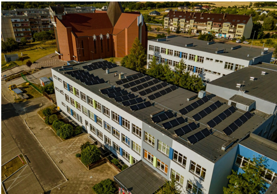
Instalacja fotowoltaiczna na budynku Szkoły Podstawowej nr 3 w Gryfinie
